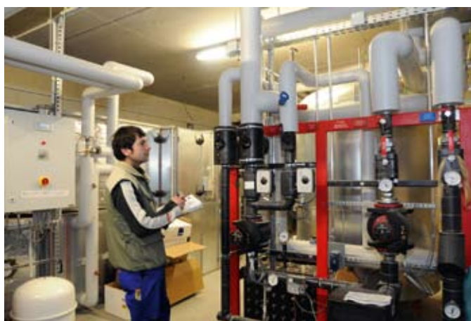
Die moderne Heizzentrale des Neubaus hält Energieverbrauch und Nebenkosten niedrig.
